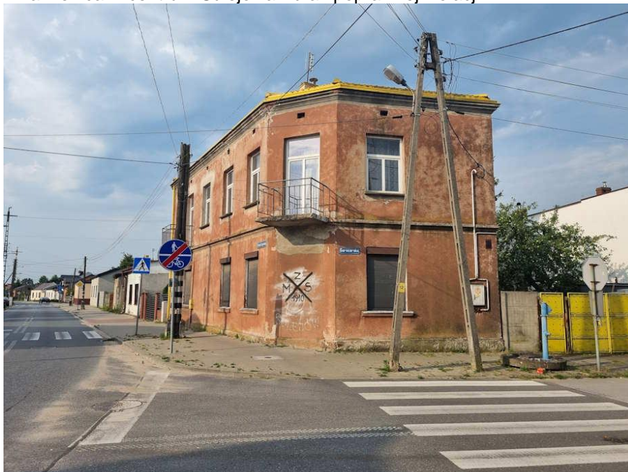
Fotografia 12. Kamienica w centrum Sulejowa - brak poprawnej izolacji
