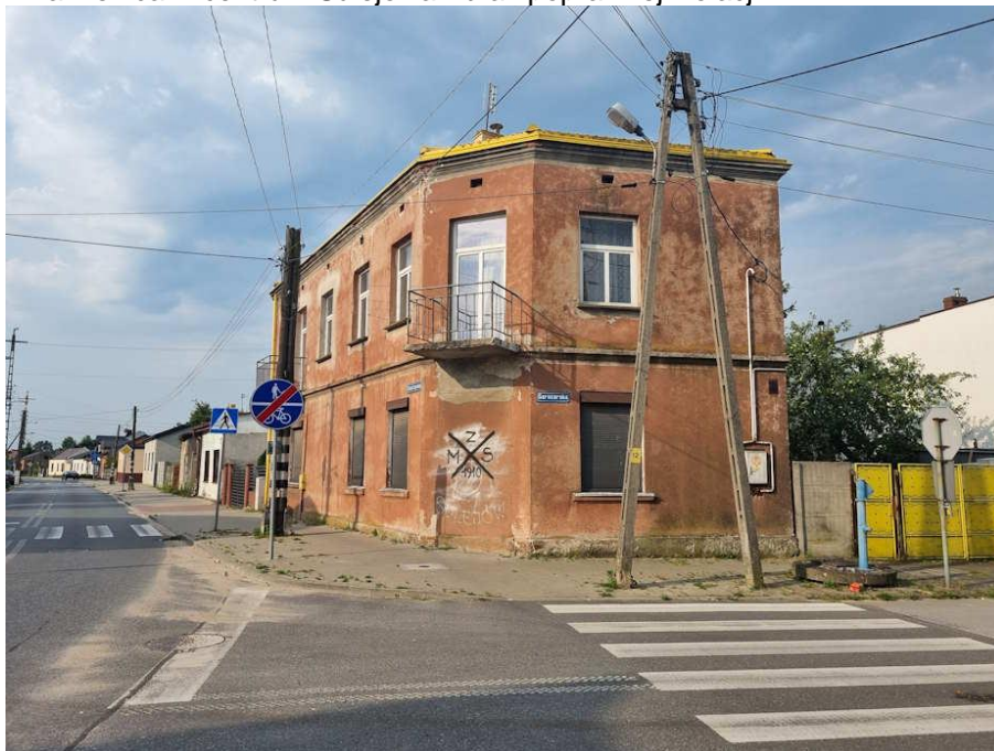
Fotografia 12. Kamienica w centrum Sulejowa - brak poprawnej izolacji
